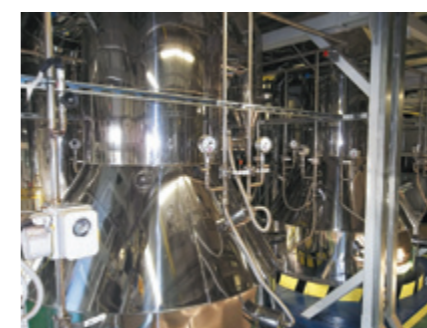
Рис. 2. Комплекс термического обезвреживания КТО-10Т.ХБПС.БМ (Кириновское НГКМ)
